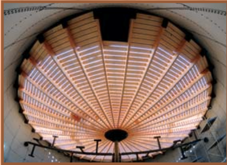
▽釧路市月寒町 バイオガスプラント
