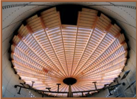
▽釧路市月寒町 バイオガスプラント
